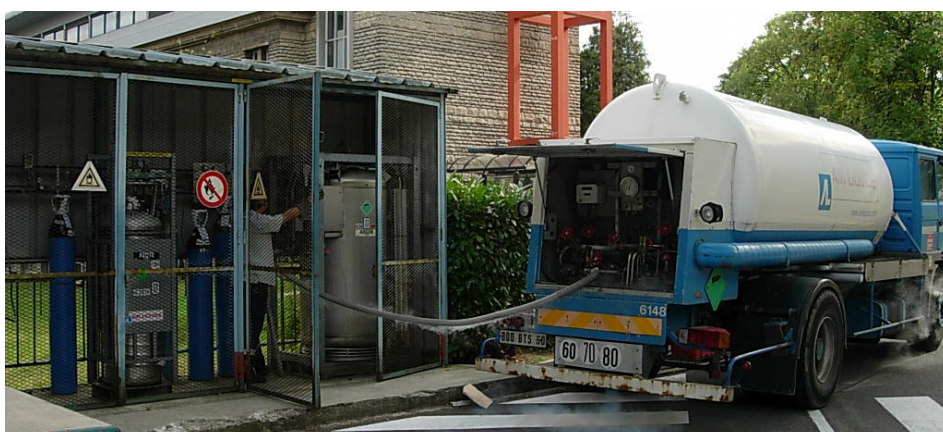
Stockage de gaz sous pression
